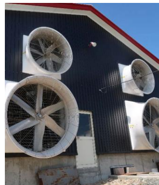
自動換気装置による 温度などの管理
